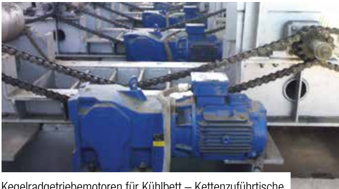
Kegelradtriebemotoren für Kühlbett – Kettenzuführtsche
